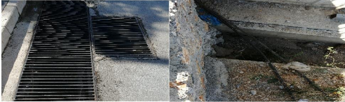
Şekil 7: Merkez (Kötekli) Kampüs İçindeki Yağmur Suyunu Kanalizasyondan Ayıran Drenaj Sistemi
